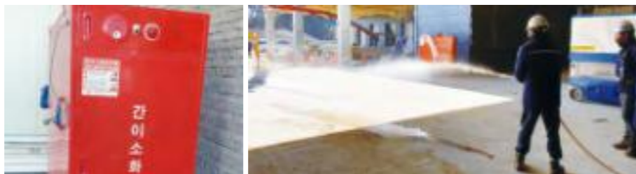
전원 미연결 간이소화장치
